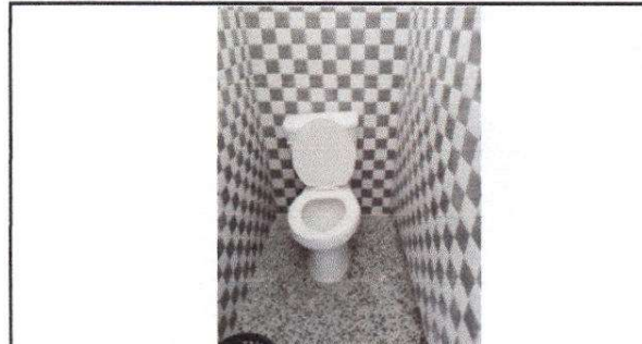
Foto 4: Sustrucción de azulejo
